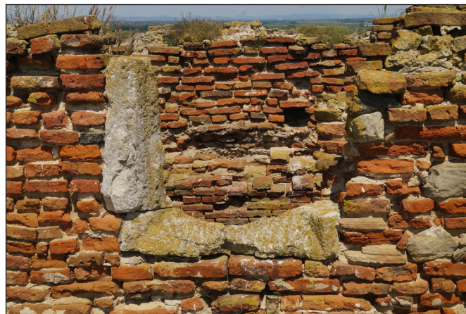
10. kép: A DK-i homlokzat harmadik emeleti ablaka restaurálás előtt
