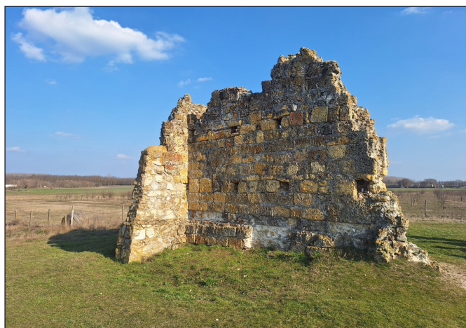
9. kép: Az északi fal helyreállítás előtt – átmenő repedések a falon, kiomlások a lábazon, mállott falkorona, heterogén támpillér kifalazás 1999-ből (fotó: Kelemen Bálint)
