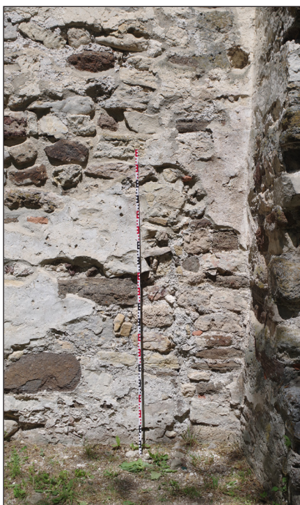
6. kép. Függőleges falelválás az északi hajófal keleti szakaszán
