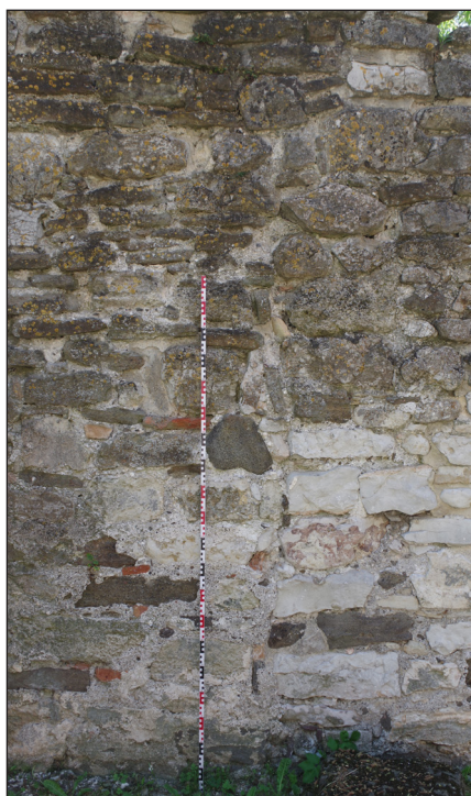
7. kép. Függőleges falelválás a déli hajófal keleti szakaszán
